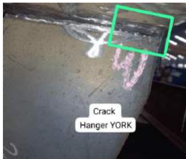
Gambar 1. Crack Pada Sambungan Hanger
