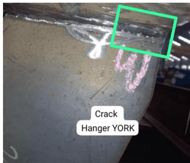
Gambar 1. Crack Pada Sambungan Hanger
